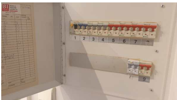
Automatsikringer er montert.
