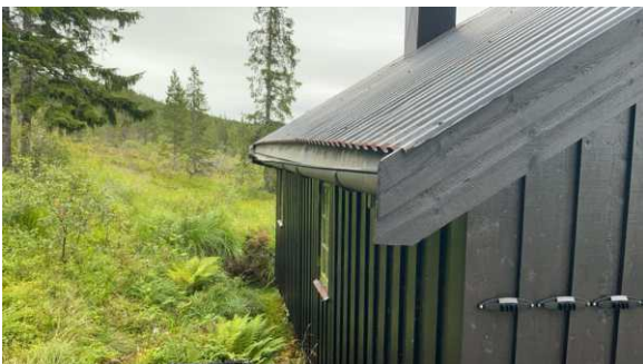
Skjevheter og skader i takrenne.
