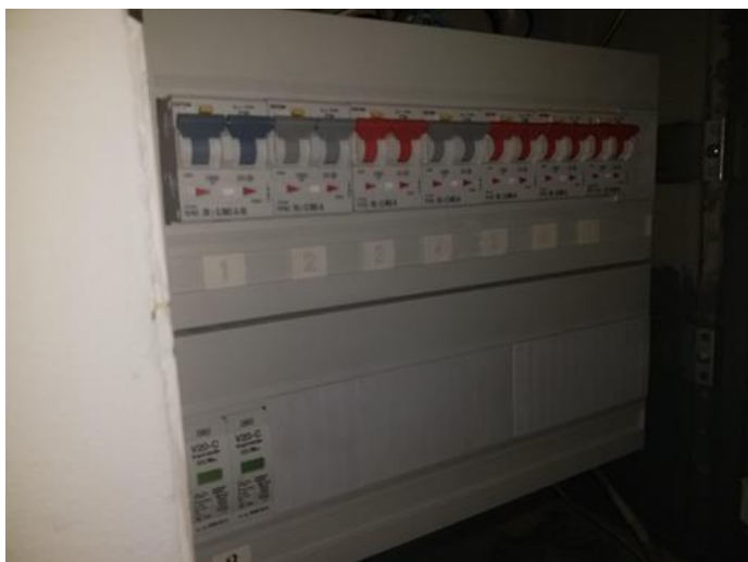
Elektrisk anlegg - [Sikringsskap. ]
