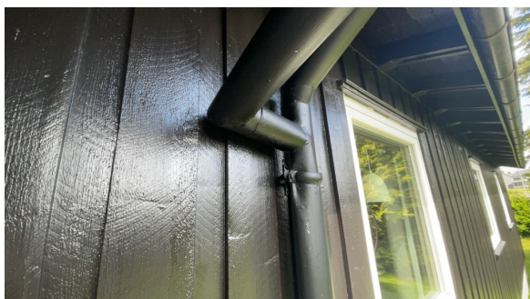
Deformasjon på nedløpsrør.
