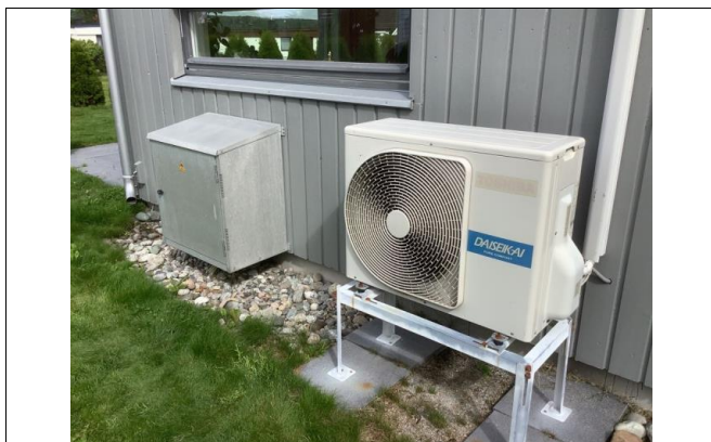
Utedel for varmepumpe og kasse for gasspåfylling.
