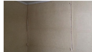
Skader i tapeten på ene soverommet.
