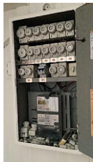
Sikringsskap med eldre innmat.
