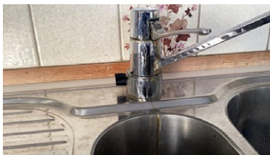
Lekkasje fra blandebeholder som renner ned i underskapet.
