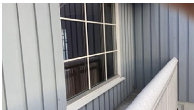
Stuevindu med noe utvendig slitasje.
