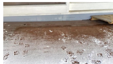
Store skjevheter i konstruksjonen.
