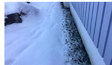
Terrengt heller noe inn mot husveggen.
