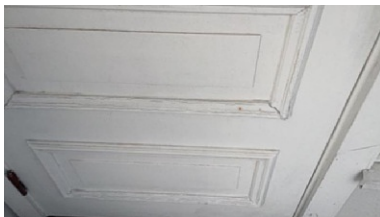
Slitasje på ytterdøren.
