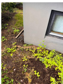
Det er ikke synlig vorteplast på sørvest side av kjeller
