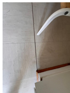
Skjøt på vinylfliser kjøkken 2 etasje
