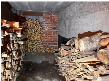
Kjeller med utvendig adkomst, fuktinnsig.
