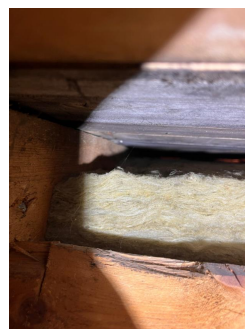
Det er stedvis liten luftespalte mellom bordtro og isolasjon
