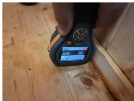
Høyt fuktnivå i gulvbord
