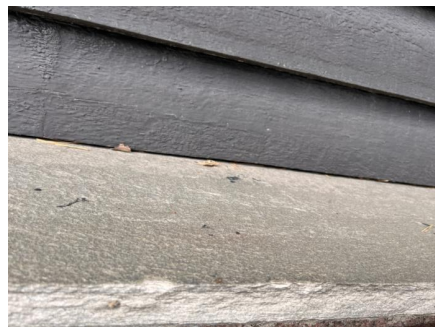
Bordkledningen er montert uten avstand til underliggende konstruksjon.
