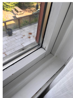
Eldre vindu på 2 etasjen, merker etter kondensvann.
