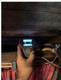
Nordvest side. Misfarget undertak, tørt på befaringdagen.
