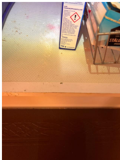
Litt fuktsvelling på skapskrog i benkeskapet.
