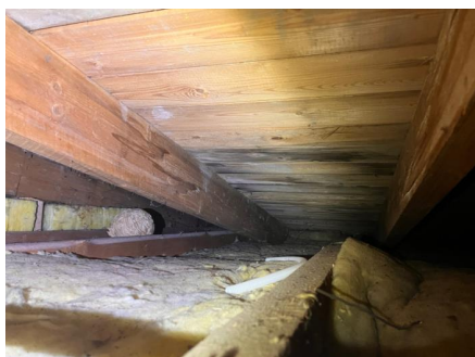
Takkonstruksjon på tilbygg fra 1972, lite lufting, misfarget bordtro.
