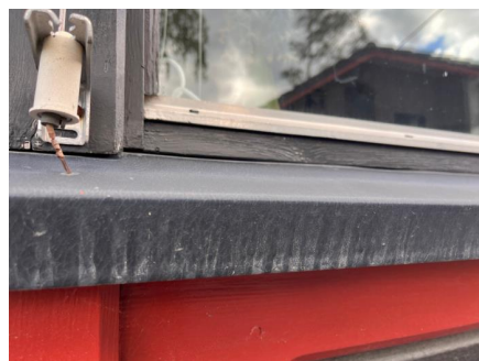
Beslag under vindu er plassert helt opp under karmen uten dryppkant
