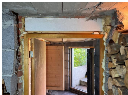
Kjeller med utvendig adkomst, skade på betongdekke.
