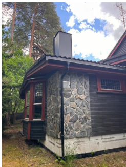
Nedløp er ikke tilkoblet rør i grunn eller utkast.
