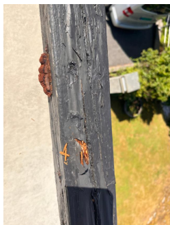
Det er råteskade på rekkverk. 2 etasje
