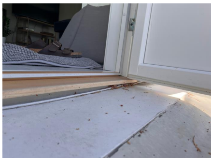
Oppkant under dør er for liten.
