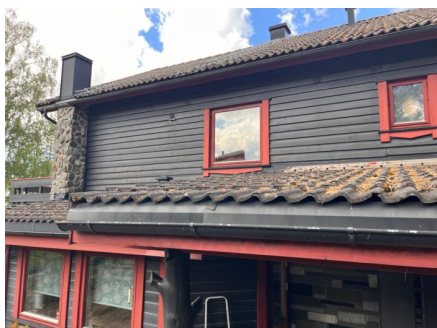
Behov for overflatebehandling
