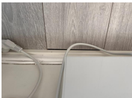
Laminat litt for kort i stue 2 etasje.
