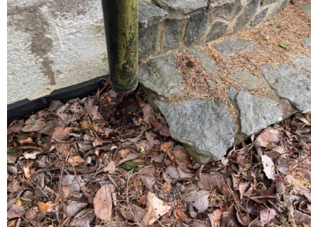
Nedløp er ikke tilkoblet rør i grunn eller utkast.
