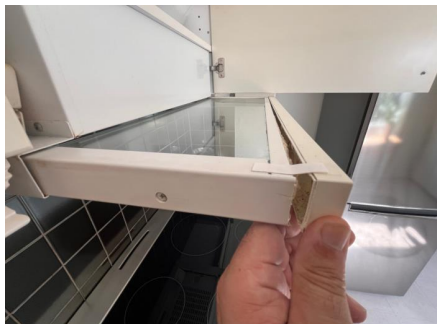
Løs front på avtrekksvifte.
