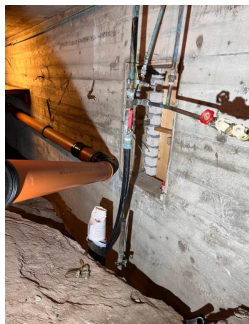
Stoppekran i krypekjeller med innvendig adkomst.
