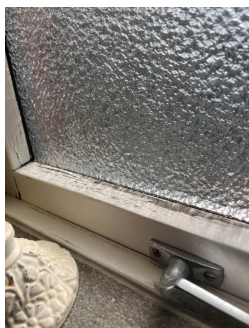
Vindu på bad 2 etasje. Merker etter kondensvann.
