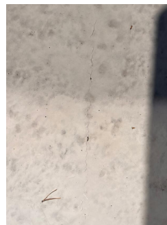
Sprekk i glassfibrermembran. 2 etasje
