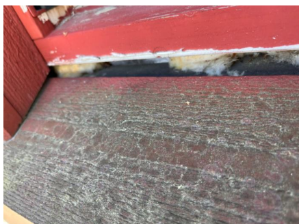
Det mangler beslag under vindu.
