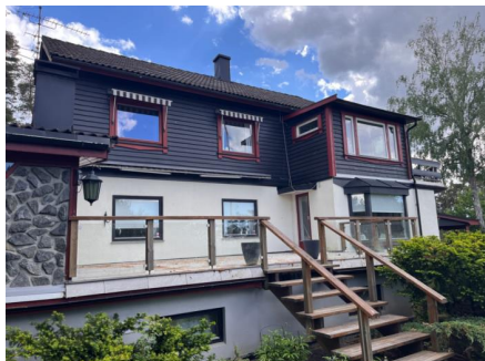
Store åpninger i rekkverket
