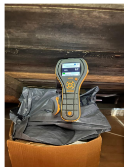
Sørøst side. Misfarget undertak, tørt på befaringdagen.
