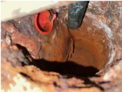
Opprinnelig støpejernsluk i dekke, ikke vært i bruk på lang tid.
