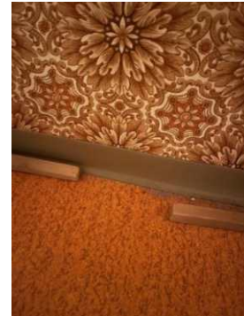
Belegg på gulv med gummlist i overgang gulv/vegg
