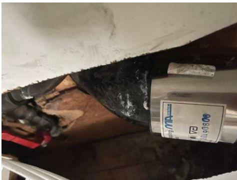
Avløpsrør i støpejern og vannrør i kobber med stoppekran (underskap ved siden av vask)
