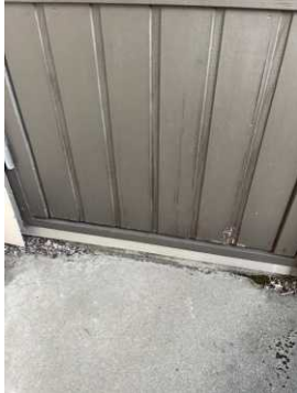
Slitt dørblad utvendig i nedkant
