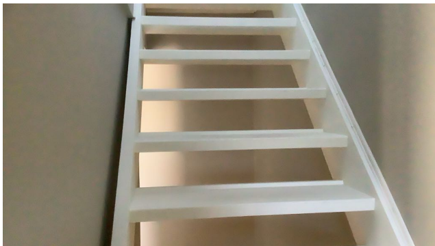
Trapp til andreetasje med for store åpninger i trinn.
