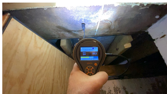
Bilde tatt over døråpning i kjeller under kjøkkenvinduet som viser fuktskader i sponplate, og noe forhøyede fuktverdier.
