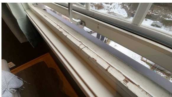
Bruksmerker på vindu i soverom
