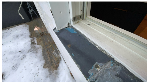
Feil/mangelfull utførelse av vannbrettbeslag kjøkkenvindu.
