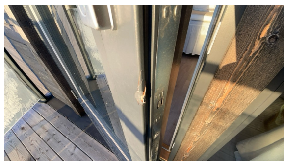
Støtmerke i dørbblad utvendig bør utbedres.
