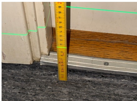
Fallforhold ca. 102 mm overkant gulv ved terskel
