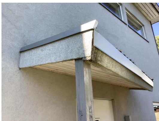
Skader i overbygg
