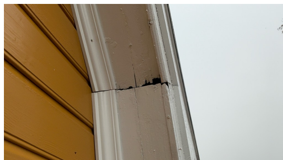
Råteskade i utstikk.
