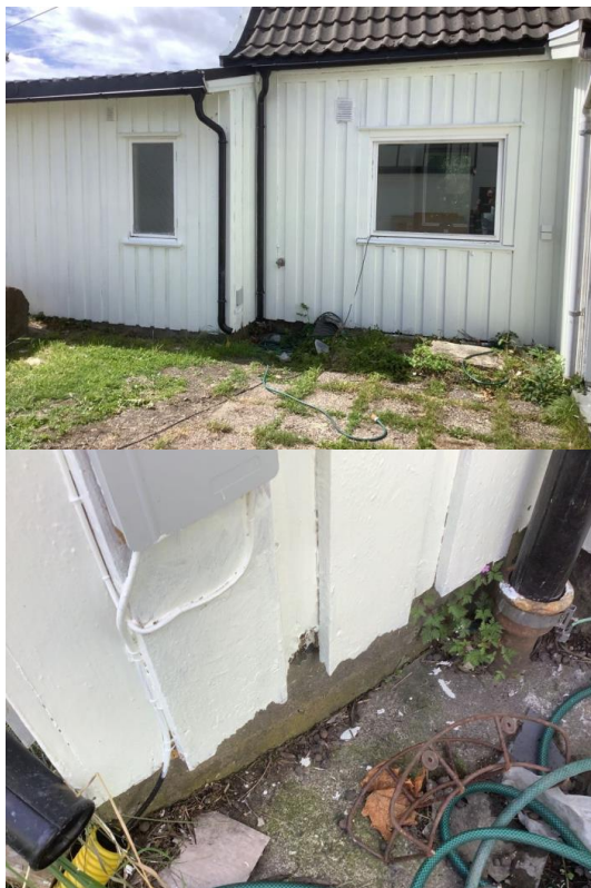
Råte i kledningen.
