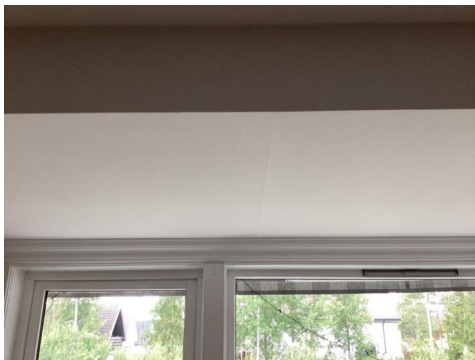
Liten sprekk i tak.
