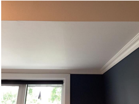
Noe skjolder i tak.
