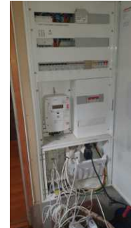
Felles skap i kjellergang. Det anbefales at det ryddes i svakstrømsinstallasjoner, slik at skapet kan lukkes.
