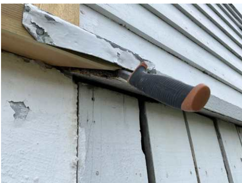
Råteskadet kledning, underside altan.
