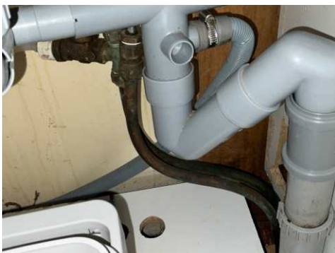
Kobberrør under kjøkkenvask
