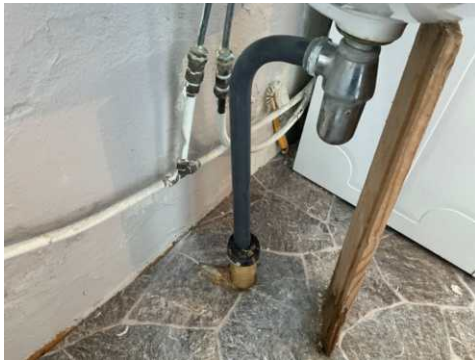
Rørøpplagg under håndvask på vaskerom. Vasken er støttet opp med et kleddningsbord.
