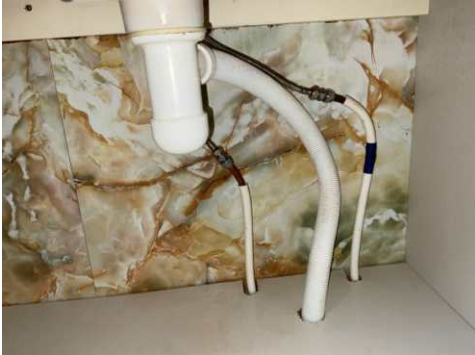
Rørøpplagg under håndvask, bad.
