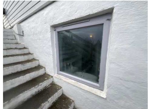
Kjellervindu: Oppsprukket i puss under vindu.
