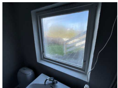
Punktert/ kondensert vindu på vaskerom.
