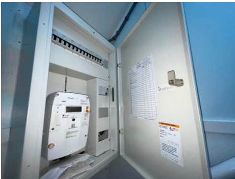
Sikringsskap i trappeløp til loft
