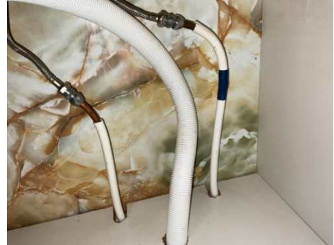
Kobberrør med plastkappe under håndvask, bad.
