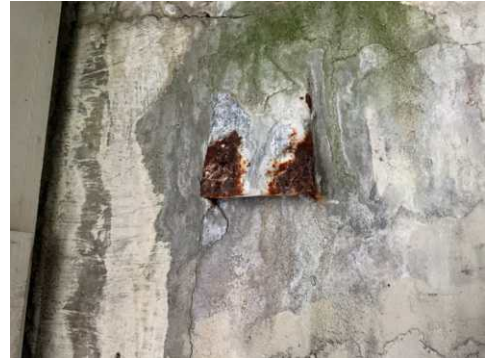
Lufteluke i kjeller er rustet.
