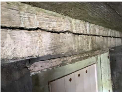
Sprekker i grunnmur i området ved khellerinngang.
