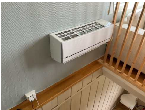
Varmepumpe i trappeløp.
