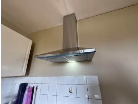
Mekanisk avtrekk over platetopp.
