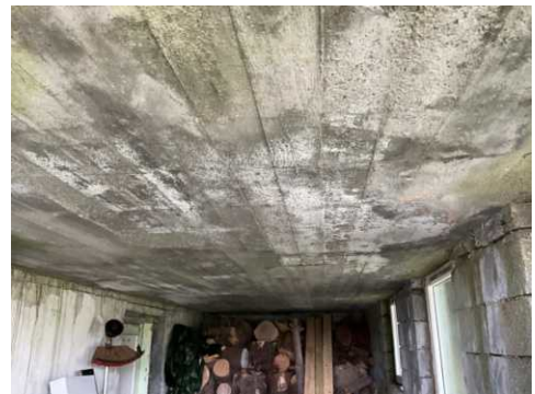
Saltutslag, underside overbygg indikerer fuktvandring gjennom betongen.
