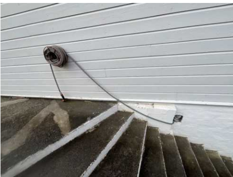
Vannuttak på yttervegg.
