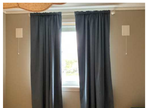
Lufteventiler på soverom.
