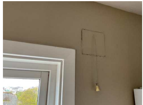
Ventilasjonsluke på kjøkken.q
