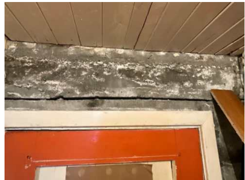
Saltutslag og sprekk i grunnmur, innside ved kjellerdør.
