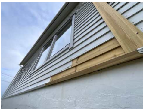
Det er ikke etablert lufting i bunn eller topp av kledningen.
