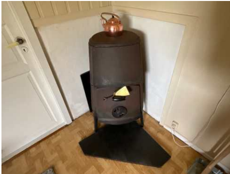
Vedfyrt ovn i kjeller.
