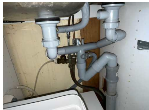
Røropplegg under kjøkkenvask.
