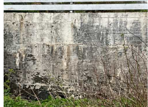
Forstøtningsmur fra byggeår: Sprekker i muren.
