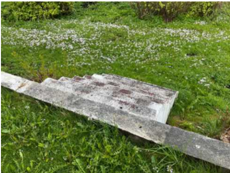
Betongtrapp uten rekkverk.
