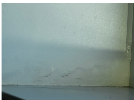
Fuktsvelling i vindusforing
