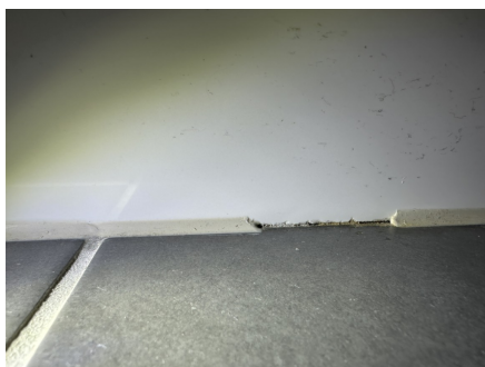
Liten/fraværene lekkasjeindikasjon fra sisternr
