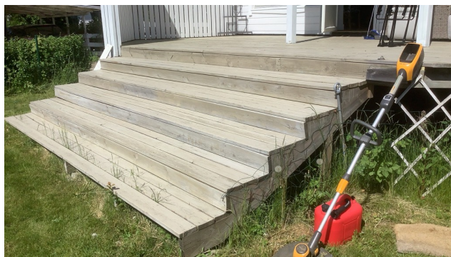
Trapp til terrasse uten rekkverk.
