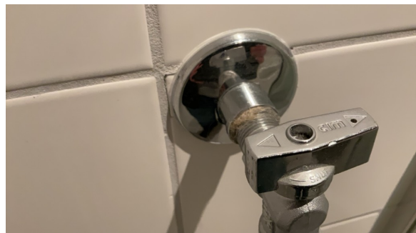
Sprekk i flis ved kran til vaskemaskin
