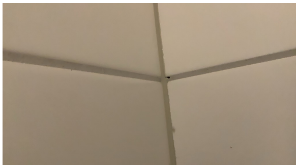
Det er påvist at flisfuger i dusjhjørne har riss.
