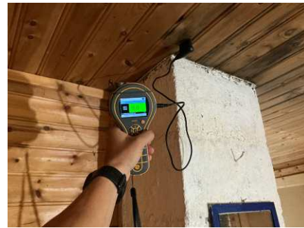
Sopp og fuktmerker i overflater registreres. Forhøyede verdier av fukt ble registrert i overflater av panel. Bakenforliggende konstruksjoner bør kontrolleres.
