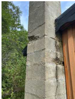
Det er skader i pipe, og det foreligger fyringsforbud på pipe.
