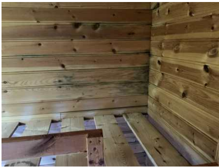
Sopp og fuktmerker i overflater registreres.
