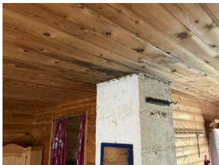
Det er fuktmerker i himling rundt pipe, samt det registreres forhøyede verdier av fukt i panel rundt pipe. Gjennomføring i tak, rundt pipe bør kontrolleres nærmere.
