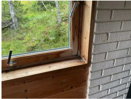
Fuktmerker i vinduskarmer.
