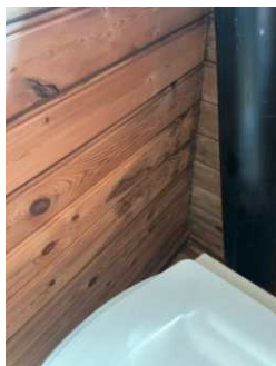
Sopp og fuktmerker i overflater registreres.
