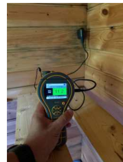
Sopp og fuktmerker i overflater registreres. Forhøyede verdier av fukt ble registrert i overflater av panel. Bakenforliggende konstruksjoner bør kontrolleres.
