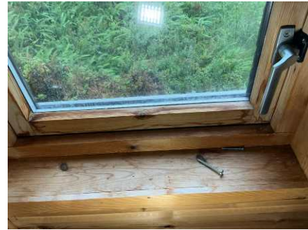
Fuktmerker i vinduskarmer.
