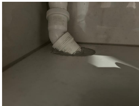
Viser rørgjennomføring uten vanntett strøpme.
