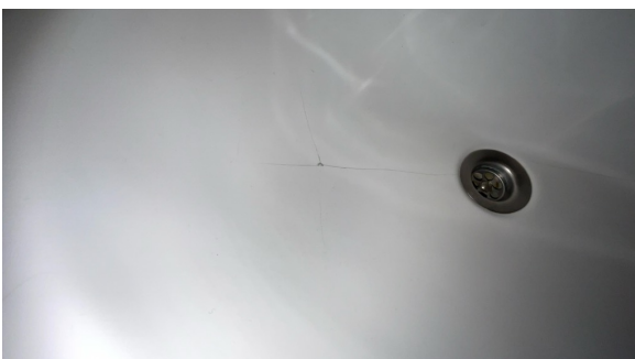
Sprekk i servanten.
