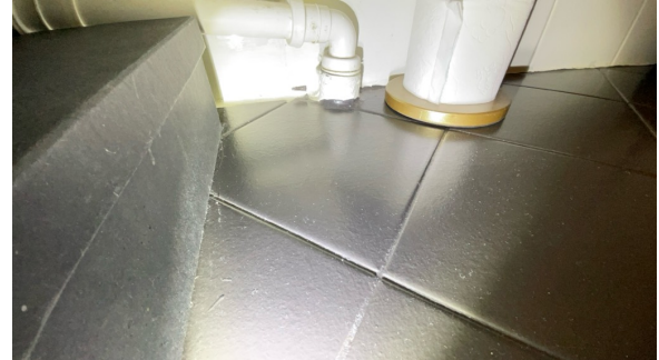
Manglende hylse/mansjett rundt rørgjennomføring i gulv.
