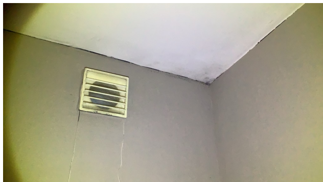
Det er fuktmerker mellom vegg og himling på soverommet.
