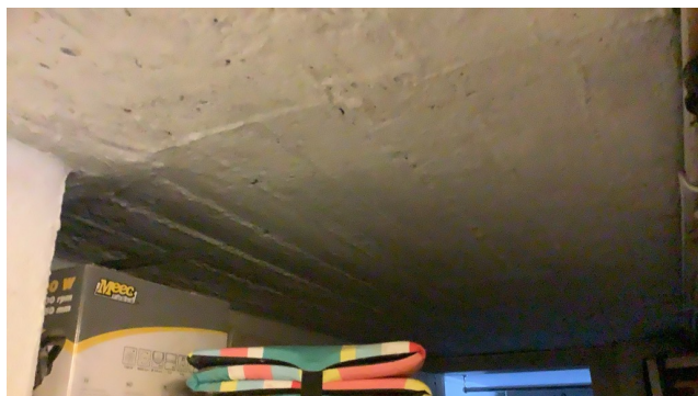
Etasjeskille mellom 1. etg og kjeller er støt
