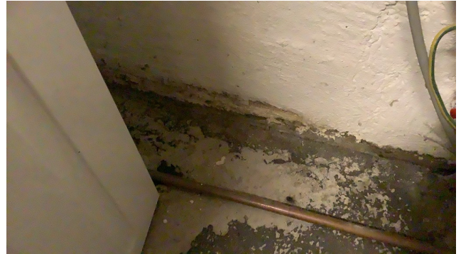
Saltutslag på murvegg i bod.
