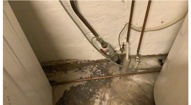
Stoppekran i kjellerbod.
