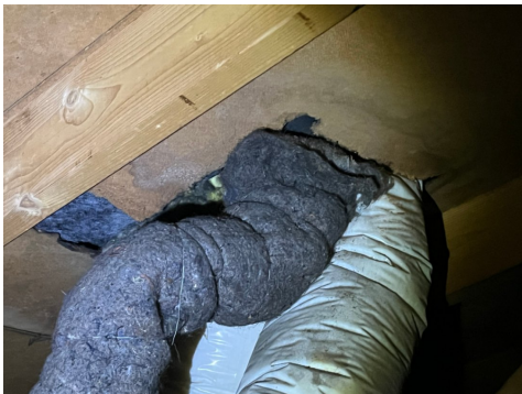
Fuktmerker i undertaket ved gjennomføring.
