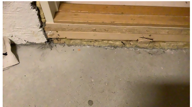
Oppforet gulv i kjeller. Det ble foretatt stikk-kontroll vedr fulkmåling, og ikke målt forhøyede verdier. Målt ved dør til kjellerbod.
