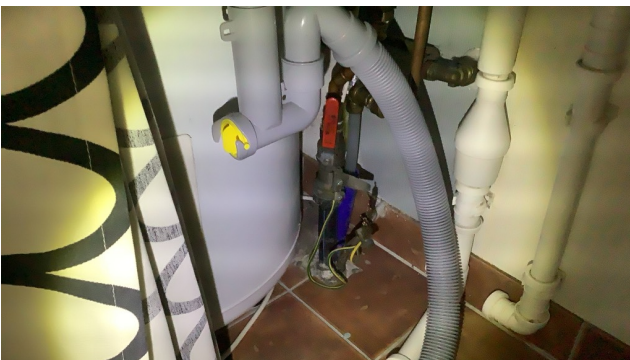
Stoppekran på vaskerommet.
