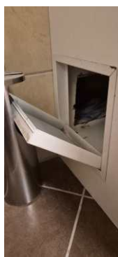
Stoppekran i luke ved siden av toalett
