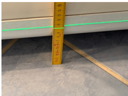
Fallforhold ca. 101 mm overkant gulv foran dusjkabinett
