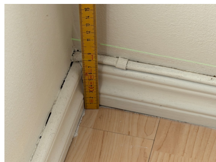
På tilfeldige steder i trappegang i 2.etg ble det målt høydeforskjell på ca. 38 mm
