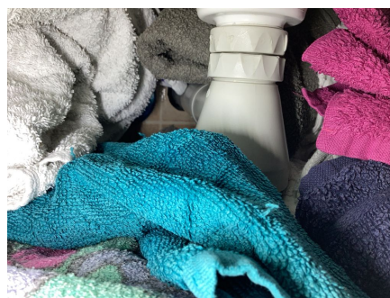
Utett rørgjennomføring i vegg under servant.
