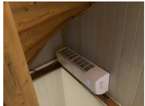
Varmepumpe i kjeller.
