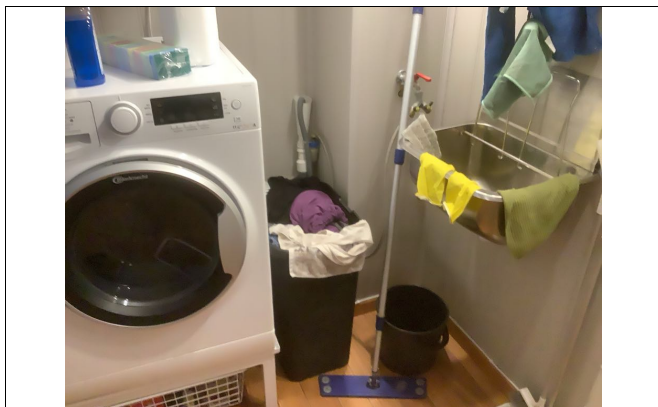
I den ene boden i kjelleren er det uttak for vaskemaskin og utslagsvask.
