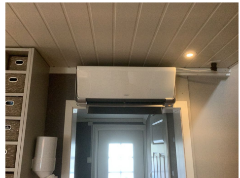
Varmepumpe i 1. etg.
