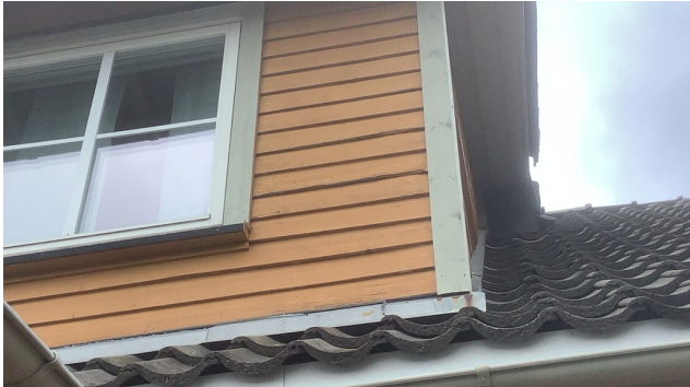
Det er større slitasje på kledningen på arken.
