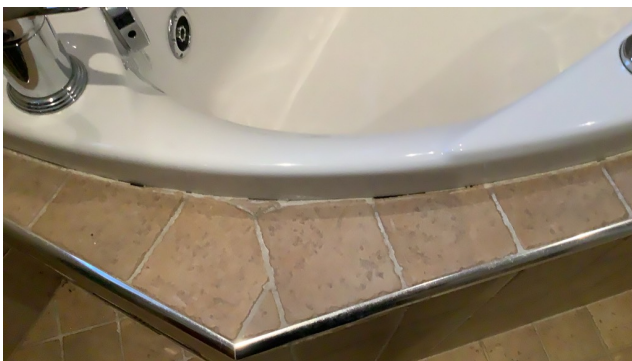
Sprekker i fuge ved badekar.
