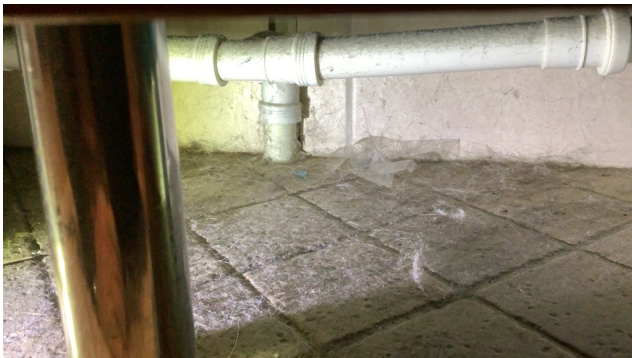
Det er ikke rørmansjett på rørgjennomføring i gulvet.
