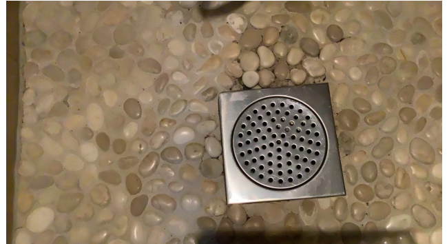
Sprekker i flisfuger i dusjnisen, og spesielt rundt sluket.
