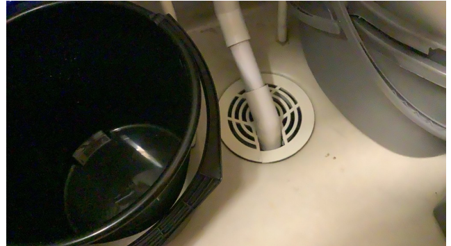
Belegget er klemt i sluket.
