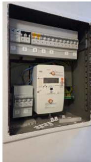
Automatsikrinjer for hovedetasje
