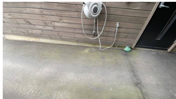
Kledning nærme terreng.
