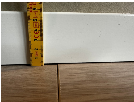
Parkettskjøter har glipper og ligger ikke jevnt/fluktende.
