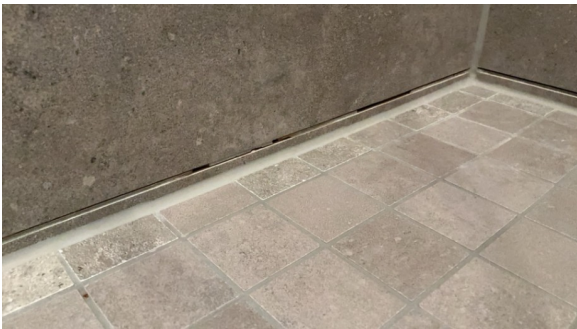
Flisfuger har sprekker
