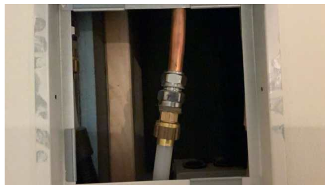
Vannrør i luke
