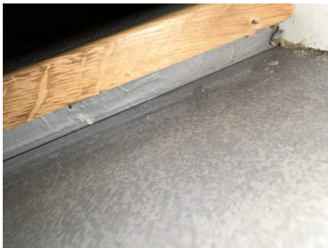
Foto 8. Membranoppkant ved dørterskel, synlig under eikelisten, ca. 12 mm over overkant flis.
