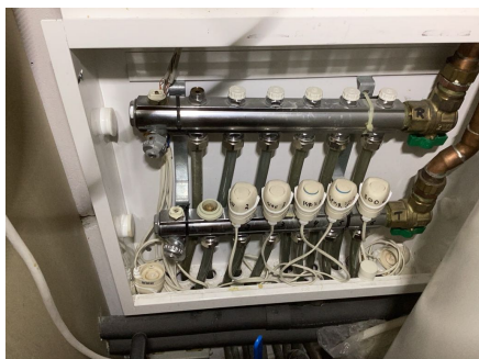
Plassert i teknisk rom i kjeller.
