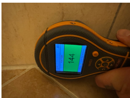
Fuktsøk ved dusjsone
