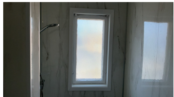
baderomsvindu ikke mulig å åpne.
