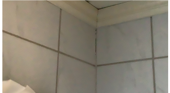
Sprekk i fuge.
