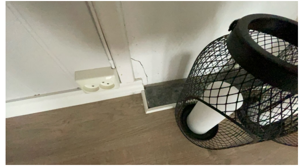
Sprekk nederst på pipa i gangen.
