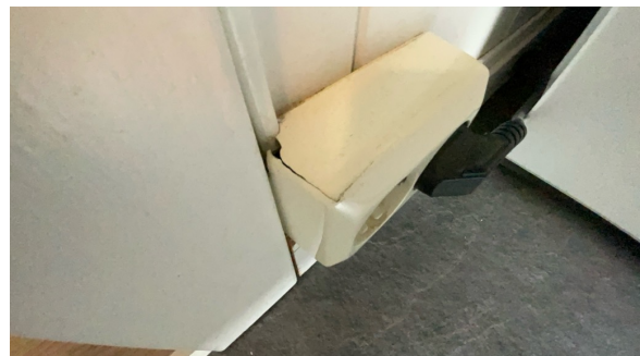
Sprekk i deksel stikkontakt kjøkken.
