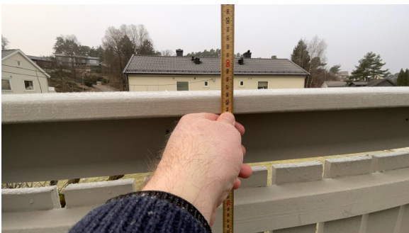
Rekkverk på balkong har lav høyde.
