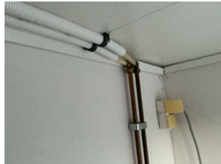
Vannledninger fra varmtvannsbereder.
