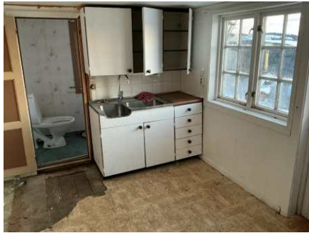
Kjøkken etablert på vegg mot bad. Det må forventes at kjøkkenet må renoveres.
