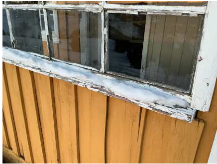
Eldre vindu fremstår med elde og slitasje.
