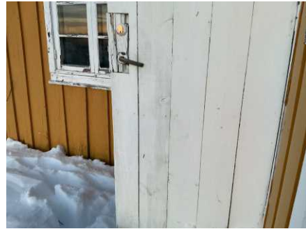
Ytterdør fremstår med elde og slitasje. Utett og skadet.
