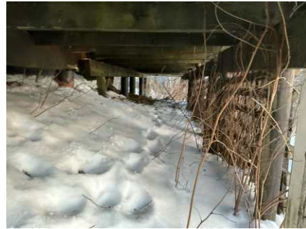
Skjevheter i bærende konstruksjoner registreres under terrasse.
