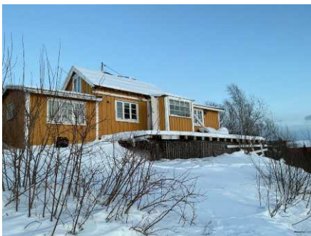
Bildet viser terrasse i front av hytten hvor rekkverk mangler.
