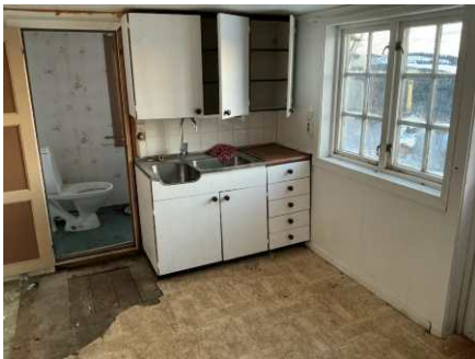
Skadet overflater innvendig. Her vises skader i gulv blant annet.
