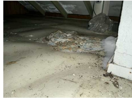
Gulv på loft er skadet og det registreres snø på loft som kommer via tak ved pipe.
