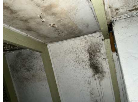
Dagslys vises rundt pipe i gjennomføring i tak.
