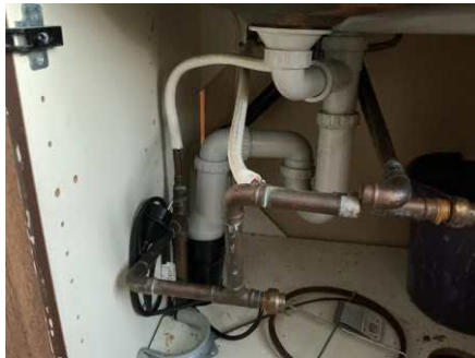
Bildet tatt under vask, å viser røropplegg.
