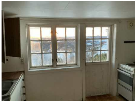
Balkongdør på kjøkken er slitt og det trekker rundt dør. Det må påregnes utskifting av balkongdør.
