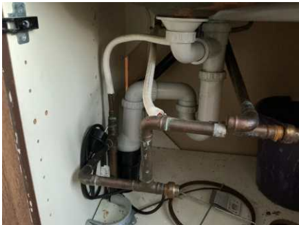
Røropplegg under kjøkkenvask.
