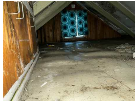
Skadet overflater på loft.
