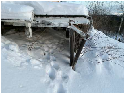
Skader i konstruksjonen registreres.
