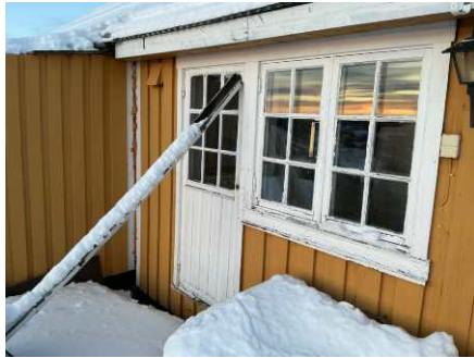
Balkongdør holdes på plass med støtte fra takrenne.
