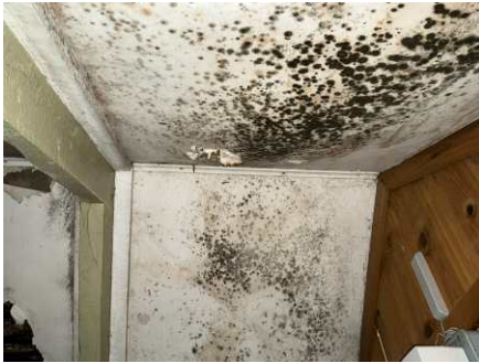
På loft er det fuktskader, mugg og soppskader i overflater.
