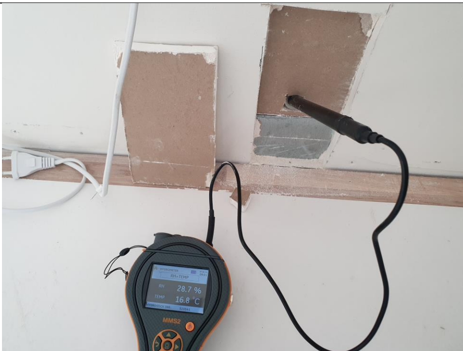
Tørre og fine verdier inne i konstruksjonen. (Kravet er under 75%Rh)
