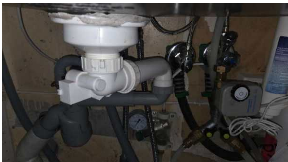
Vann- og avløpsrør i kjøkkenbenk
