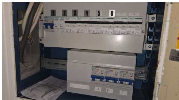
Automatsikringer er montert.
