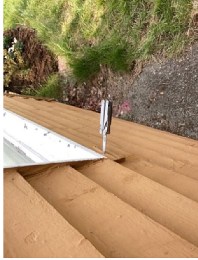
Råte i kledningen.
