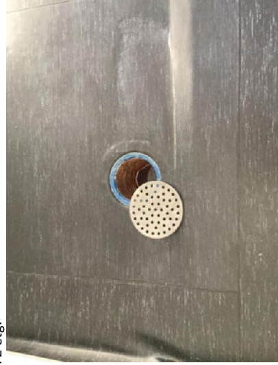
Rustskader i sluket.
