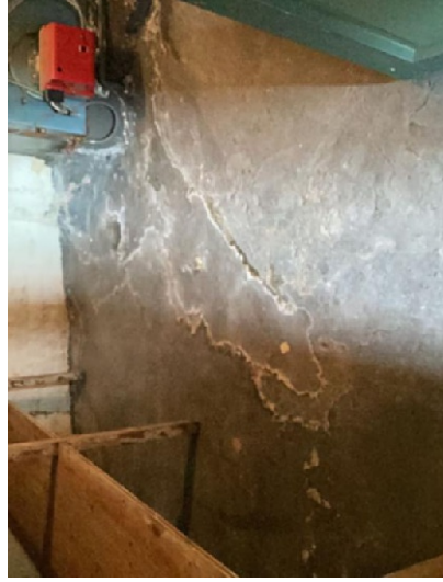
Saltsutslag i dekket på tekrommet.
