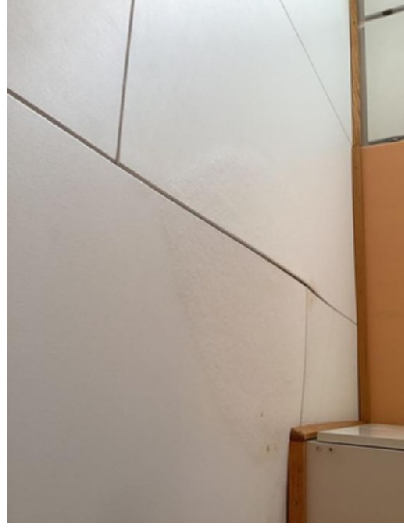
Fuktskader i himlingen i 2 etg.
