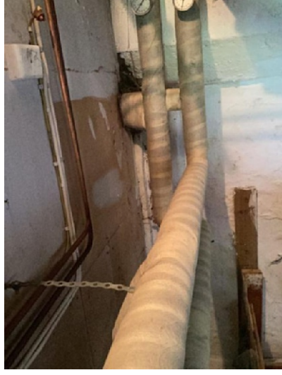
Vannrør isolert med eternitt.
