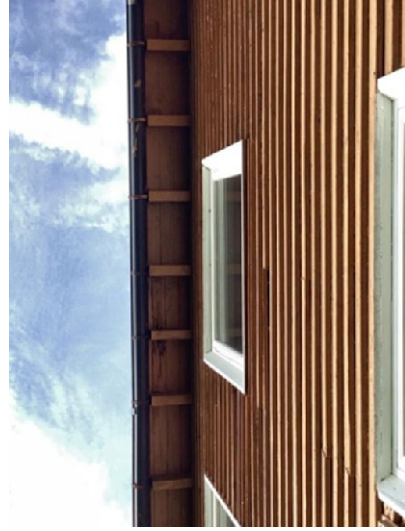
Råte i undertaket.
