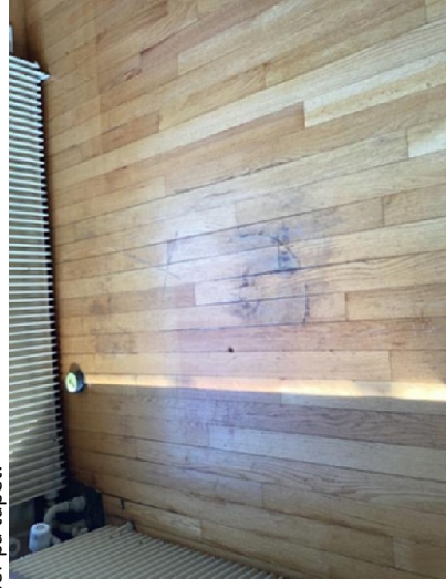
Skader i parketten i stuen.
