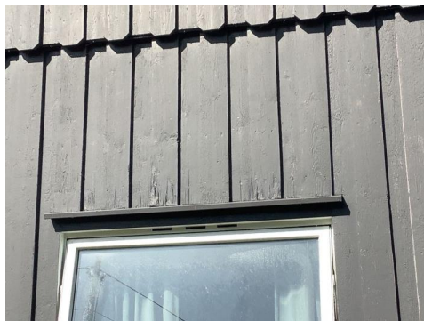
Råte skader over vindu
