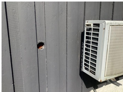
Varmepumpe er koblet ut. Hull i vegg må tettes
