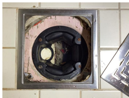
Synlig varmekabel i sluk.
